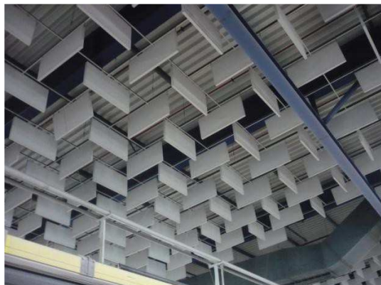
Plafond de local industriel avec baffles
